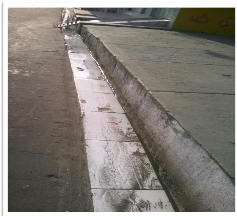
Figura 24 - Esgoto que corre em vala azulejada para facilitar a limpeza
